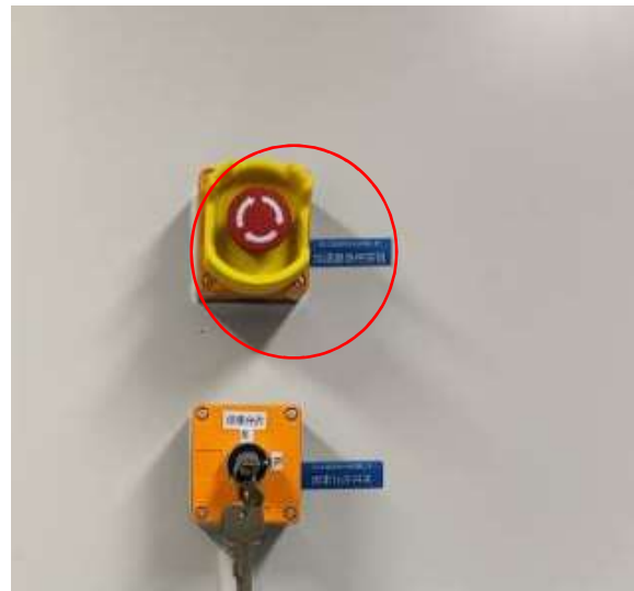
(b) 控制室内急停按钮
