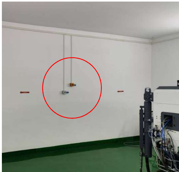
(a) 机房内急停按钮
