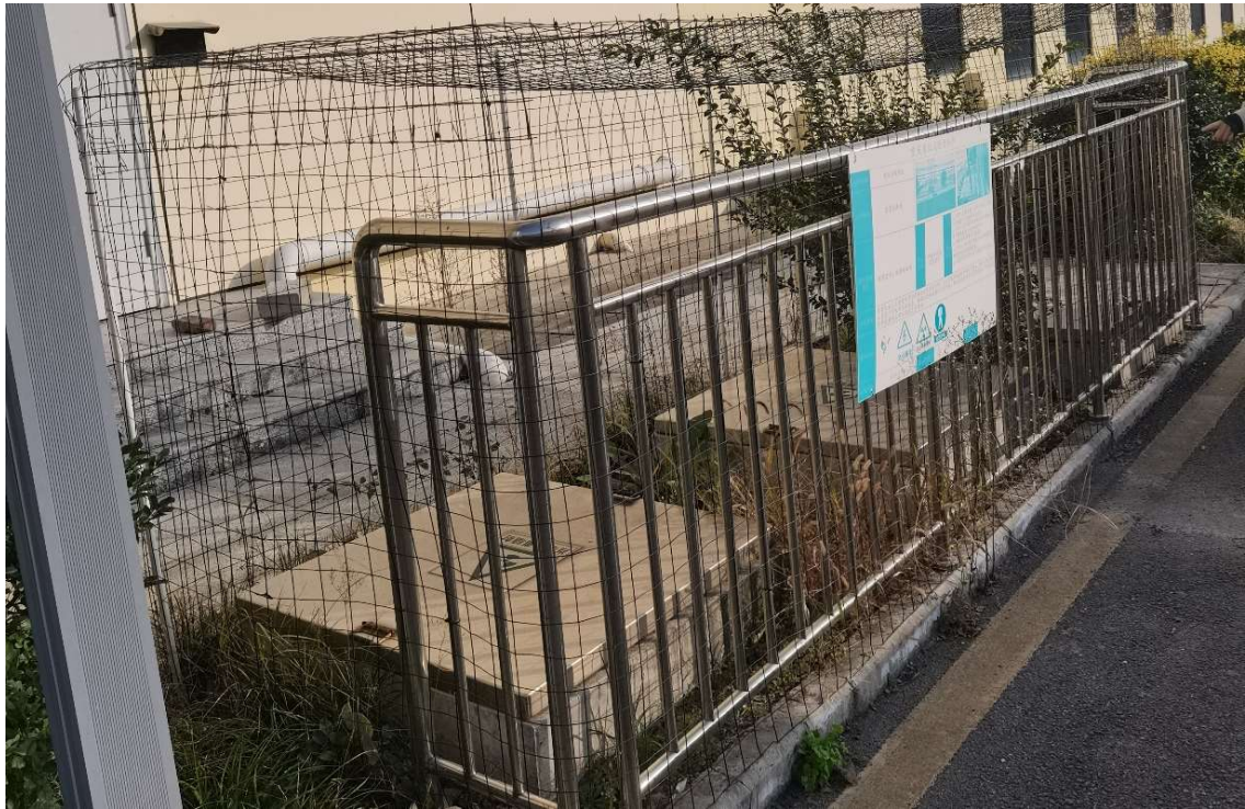
图 3-14 本项目衰变池系统实拍图
