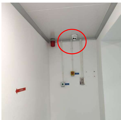
(a) 回旋加速器室迷道监控装置
